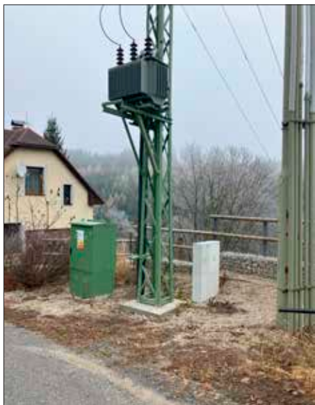
rozvaděč VO Bratříkov
